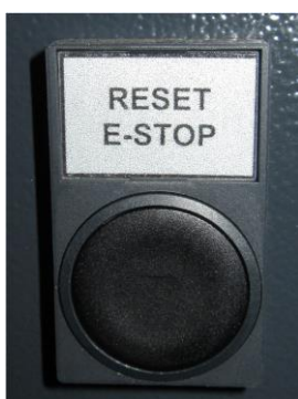
Reset na rozvaděči
