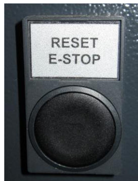
Reset na rozvaděči
