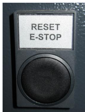
Reset na rozvaděči
