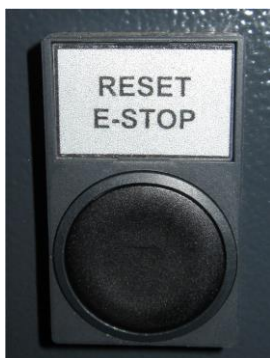
Reset na rozvaděči
